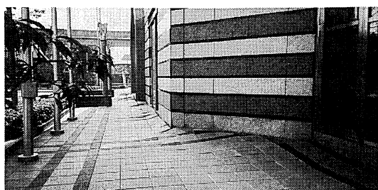
写真2 UCC コーヒー博物館の建物基部の外構部の沈下状況
