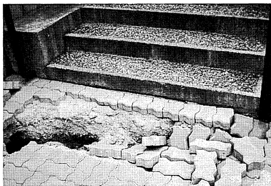
写真1 敷地内の陥没隆起
